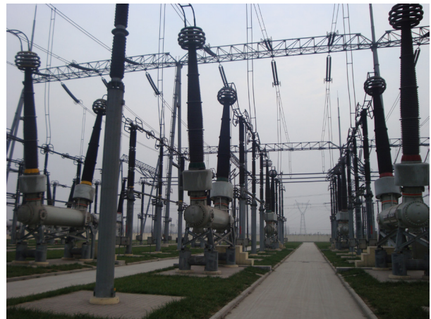
图 1 500kV 罐式开关比较高，离其他的运行设备近。
