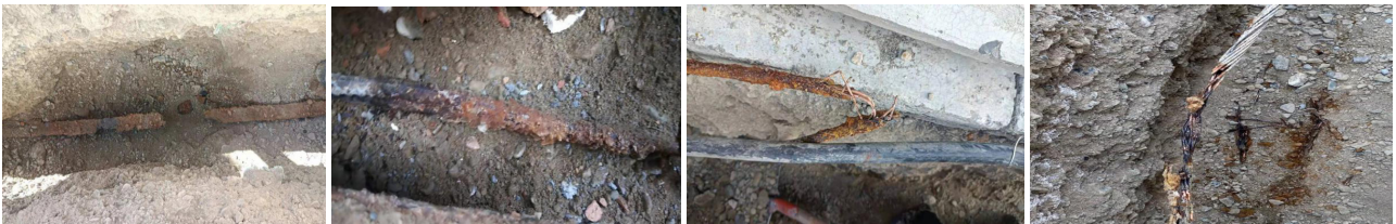
图1 牵引变电所主接地网现场情况
