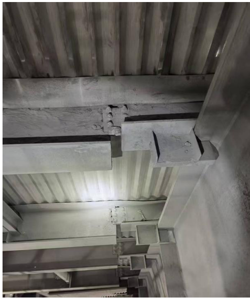
图 1 刚性梁连接板拉裂
