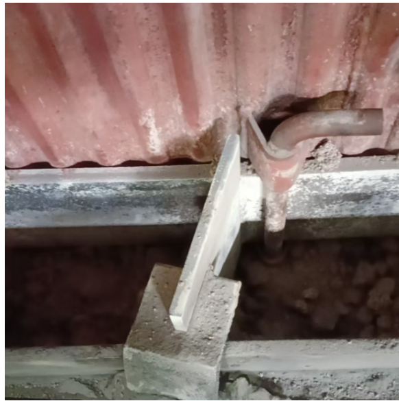
图 2 刚性梁定位卡变形
