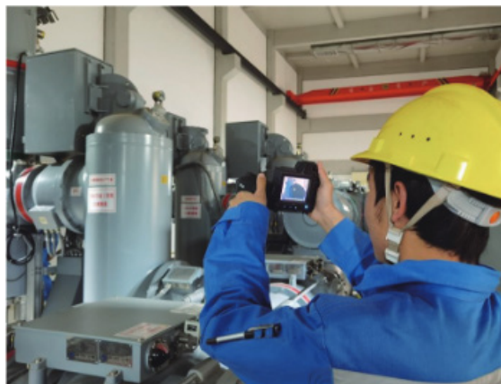
图1 变电站巡检中红外测温图
