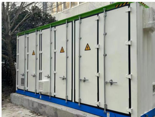
图3 储能系统全貌图
