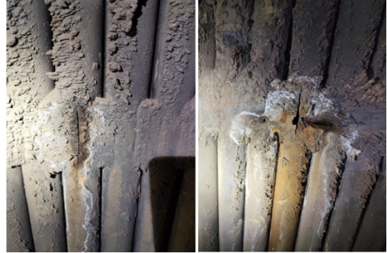
图2 壁式再热器纵向裂纹泄漏
