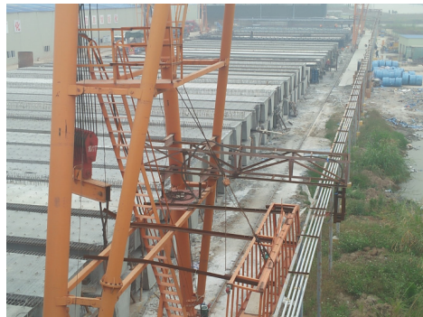
图1 三台龙门吊采用滑线供电
