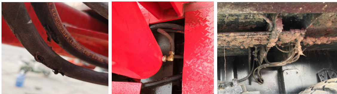
图2 修井机液气管线管线破损、无防护
