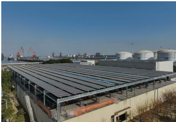
图 1: 光伏系统在污水厂处理池的应用
