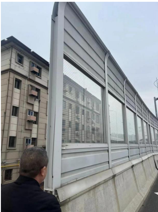
图 1: 桥面挡风屏钢化玻璃材质
