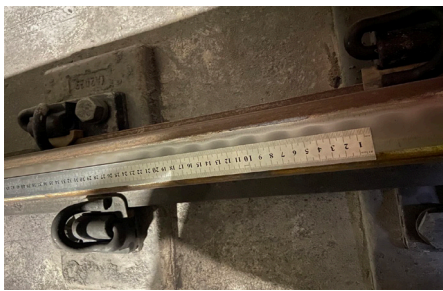
图 1 现场钢轨波磨情况
