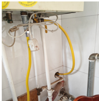
图四燃气软管穿墙
