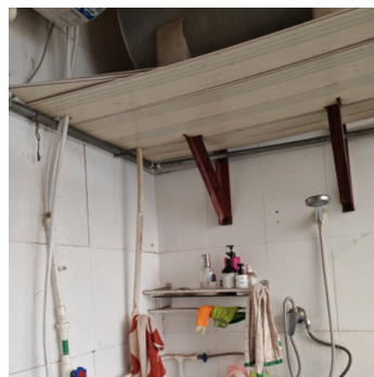
图五燃气管道穿浴室且上方搁置重物
