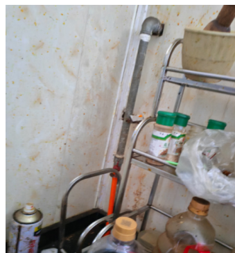
图六燃气软管非专用燃气专用管
