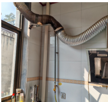
图二燃气管道上附着排烟管道
