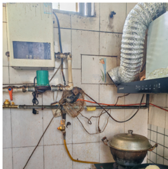
图一 燃气管道与电线缠绕，悬挂重物
