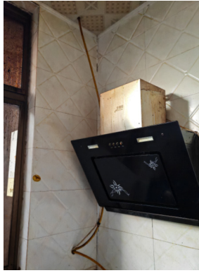
图七燃气软管穿墙且长达大于2m
