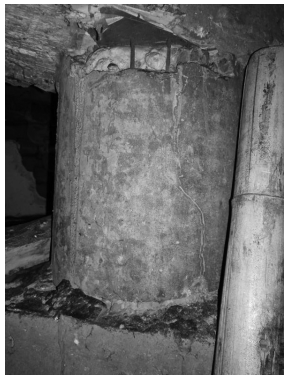
图10 屋面支撑柱端部未有可靠连接
