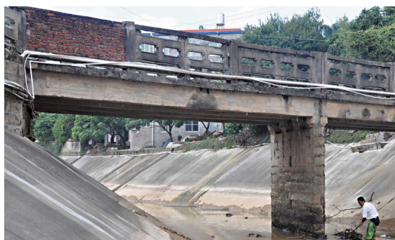
图1 老化的水利设施
