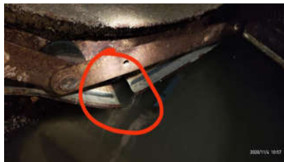
图 4 旋转滤网导轨水下部位断裂缺陷
