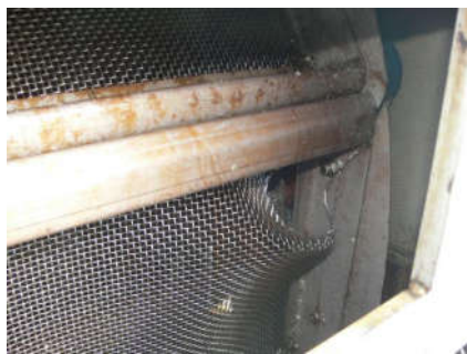
图2 被海生物压损后的滤网过滤网板
