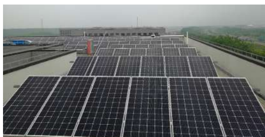
图4 屋顶光伏电路板
