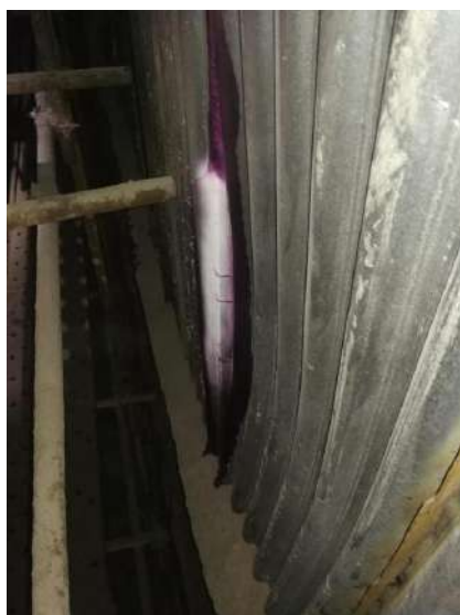
图 15 该位置水冷壁变形情况
