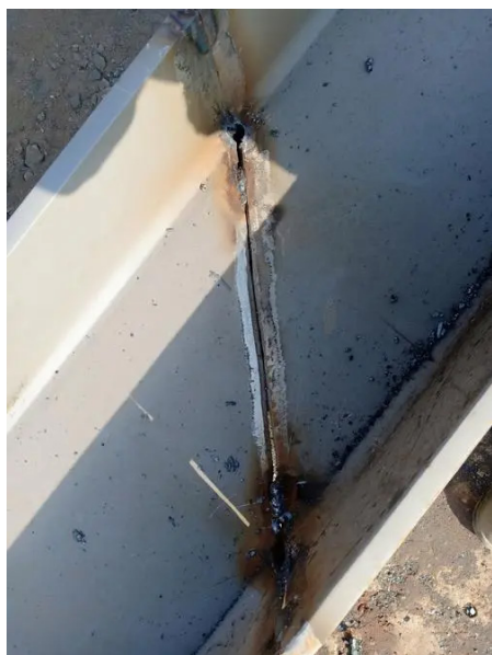
图1 钢结构桥梁裂纹
