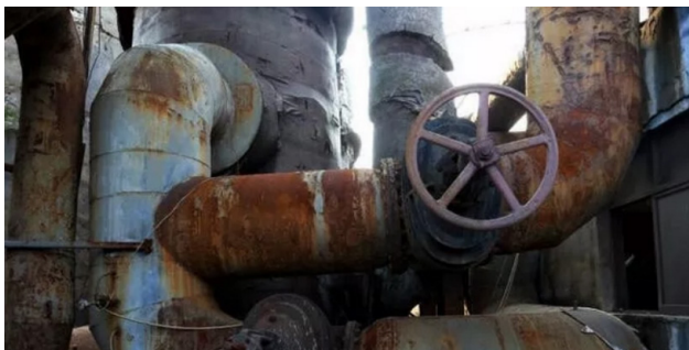
图1 管道腐蚀示意图
