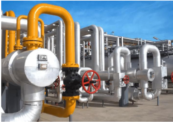
图1 化工工艺管道
