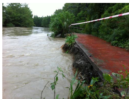
江安河万春镇报恩村4组堤岸垮塌40米
