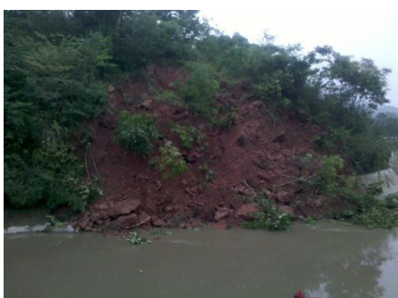
新南干渠 41+300 山体滑坡
