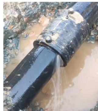
图1: 供水管道密封圈受损引发的喷涌图
