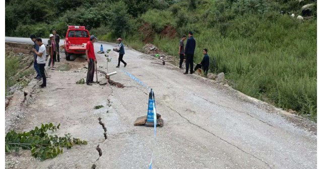
滑坡发生后的裂缝
