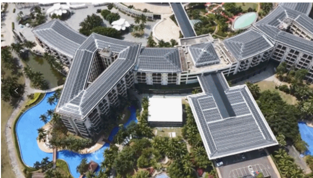
图1:某酒店屋面光伏组件和连廊光伏采光顶
