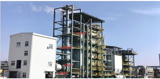
图 3 分体式回转窑及废液炉现场照片
